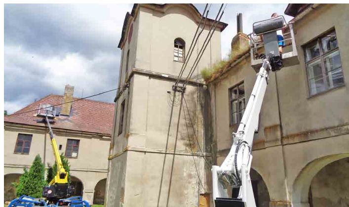
Některé šablony na střeše byly popraskané. Foto: Štefan Dvorščík
