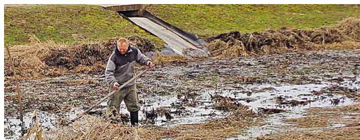
Kořenová čistírna vyžaduje pravidelnou péči. Foto: Archiv obce
