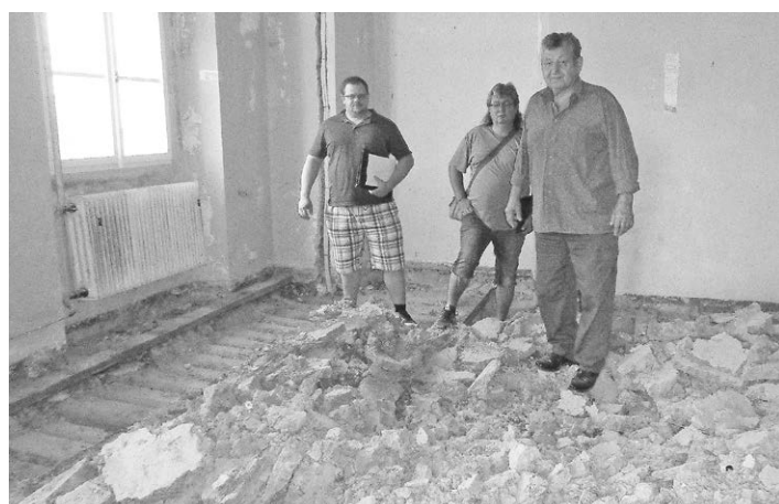
Podlahy v patře jsou v žalostném stavu. Foto: archiv autora 3x
