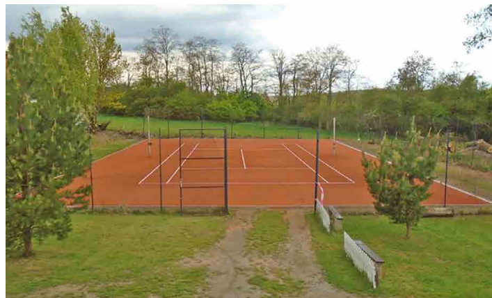
Oprava kurtu stála více než čtvrt milionu korun. Foto: Jiří Guttenberg
